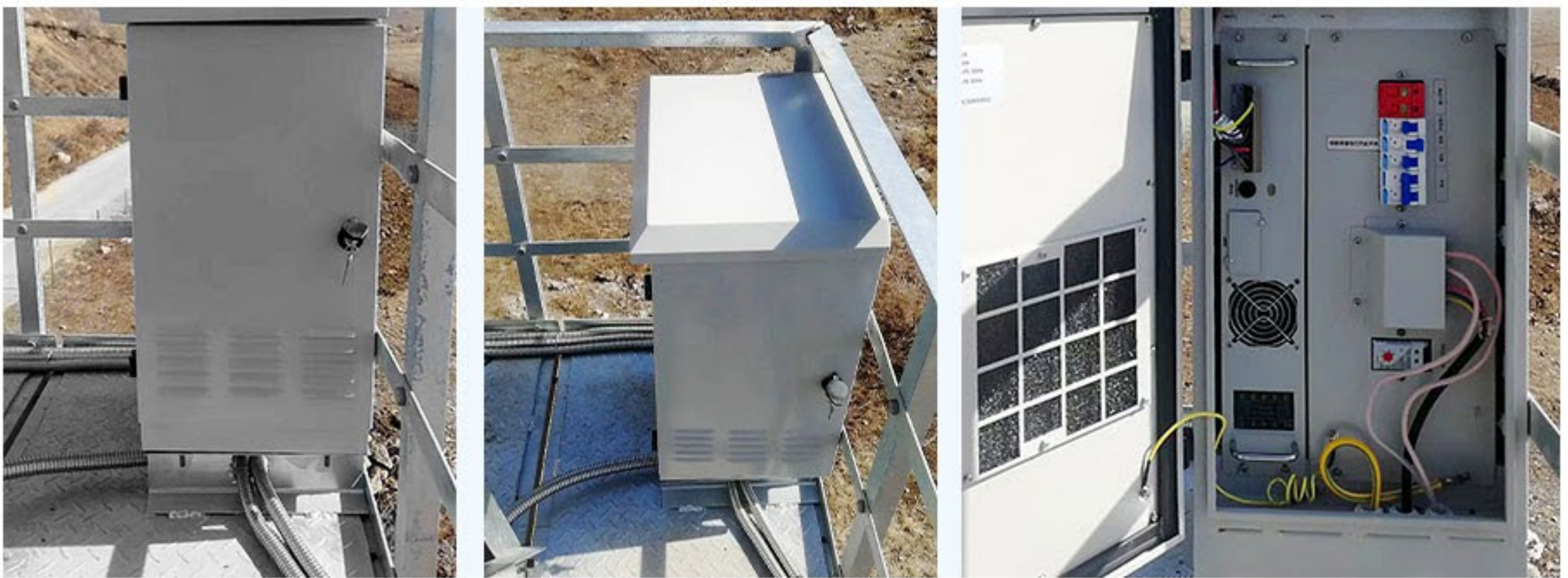
地点: 中国吉林省延边朝鲜族自治州 项目: 户外不间断电源 1KVA, 配有 150W 加热器和内置 3 个 12V 17Ah 铅酸电池。
