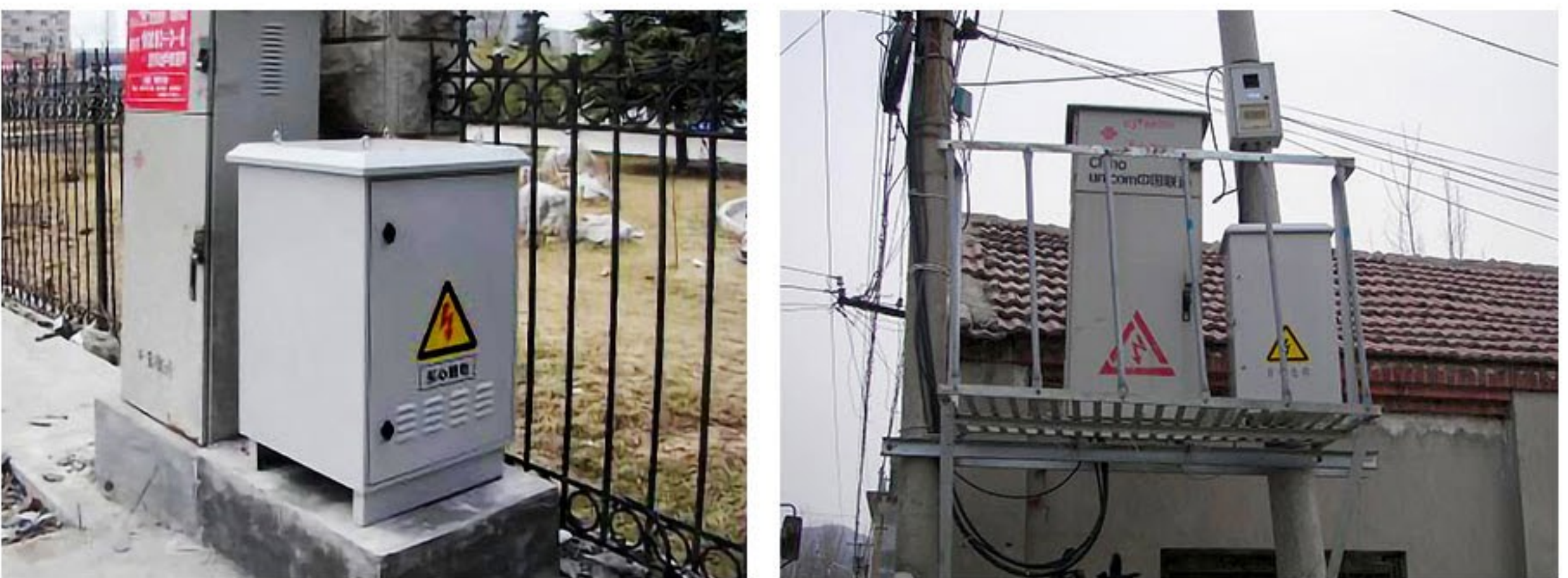
地点: 中国岳阳市 项目: 为中国联通提供内置铅酸电池的户外不间断电源。
