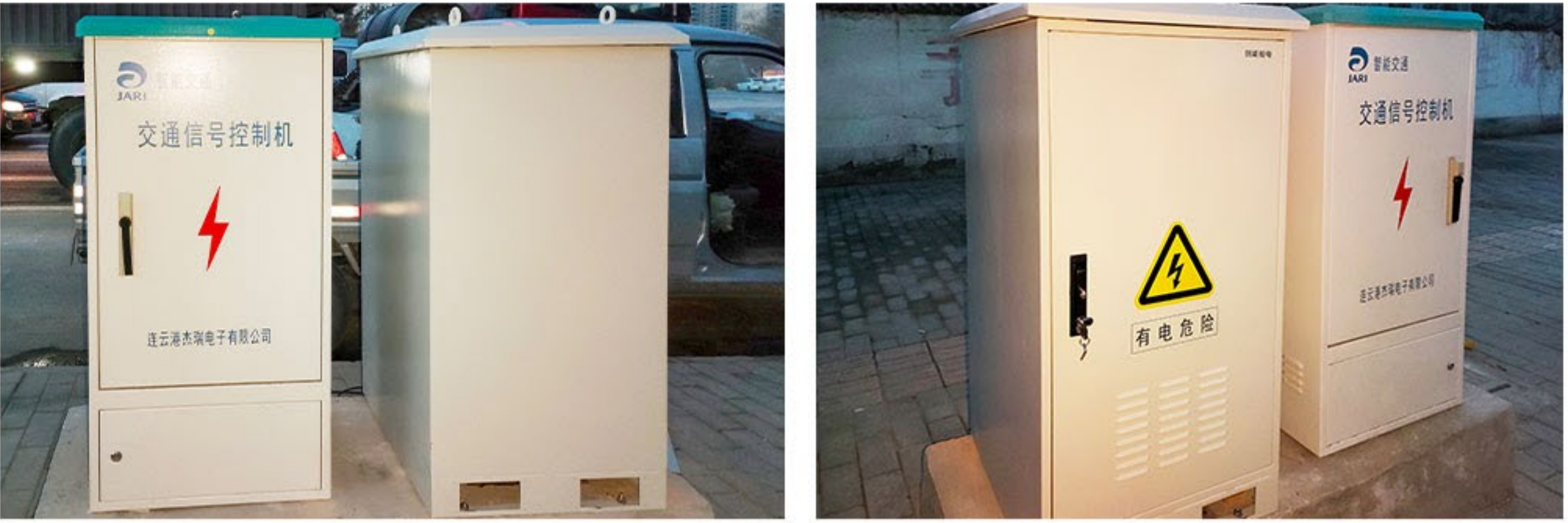
地点: 中国连云港市 项目: 用于交通管制的室外不间断电源, 连云港民用项目。
